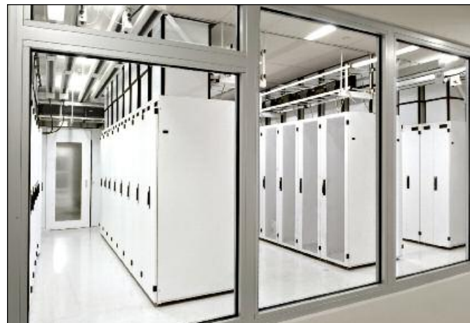
En un esfuerzo por construir la instalación de colocación más verde de Oregon, BendBroadband Vault desplegó el Passive Cooling® de CPI y aislamiento de calor al instalar el sistema de gabinete TeraFrame® de la serie F con ductos de escape verticales.
