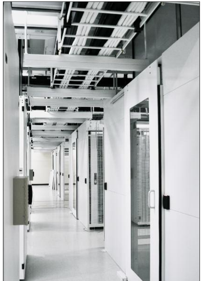
CPI utilizó soluciones personalizadas tales como escalerilla porta cable y organizadores de cables de CPI en color blanco, para asegurar que la estética de Vault coincidiera con aquella de una instalación de muestra con una apariencia de alta tecnología.
